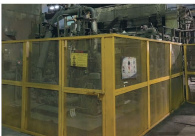
煤氣系統區域進行安全隔離、實行准入制。
