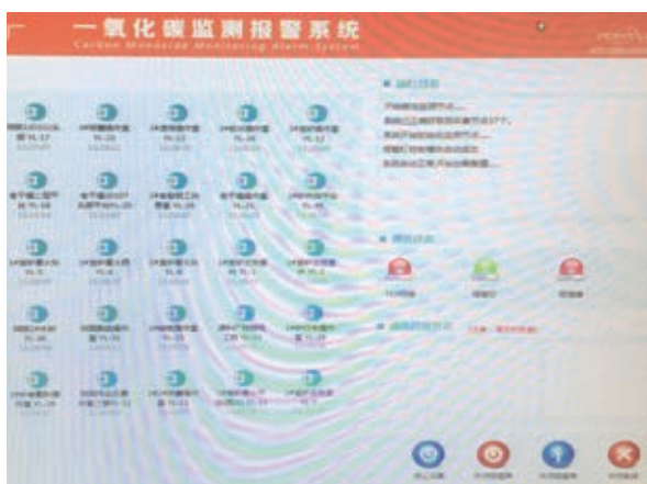
煤氣區域報警器進行聯網集中預警管控
