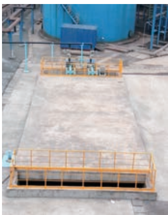
360 燒結脫硫廢水收集
